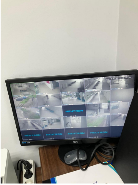
Fotoğraf 1. Fakülte binası kamera izleme sistemi monitörü
