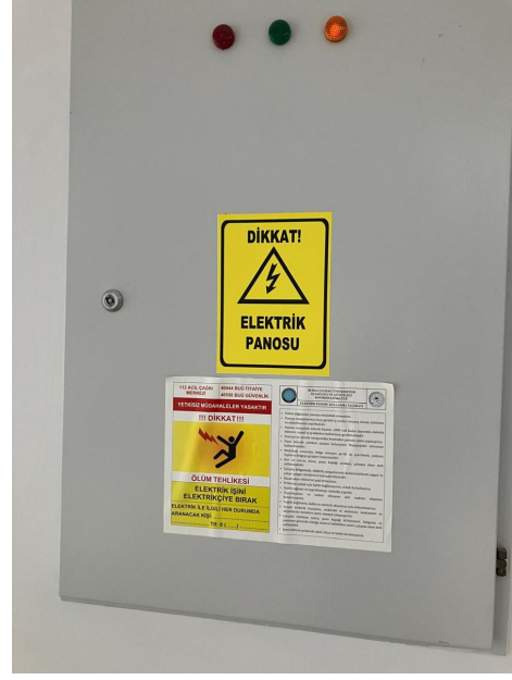
Fotoğraf 15. Elektrik panosu uyarı levhaları
