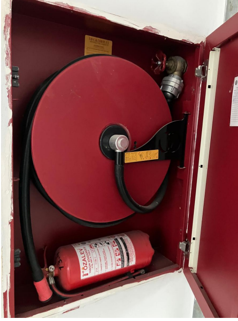
Fotoğraf 4. Yangın dolabı içi: yangın hortumu ve yangın söndürücü
